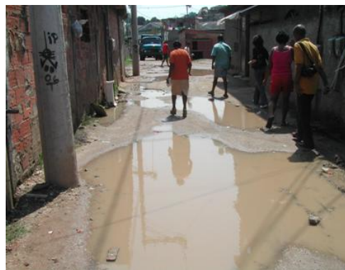
Deficiência do sistema de drenagem, Travessa Estrela. Fonte: NEPHU
