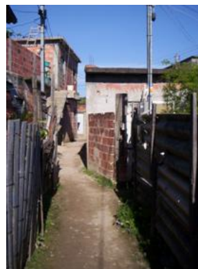
Casas construídas em alvenaria e sem emboço Fonte: NEPHU
