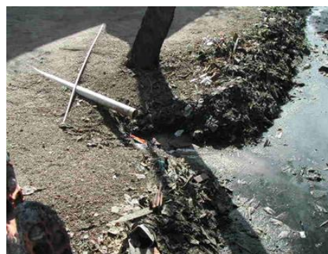
Detalhe da tubulação que leva esgoto aos canais. Fonte: NEPHU
